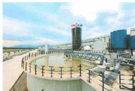
Hệ thống xử lý nước thải
